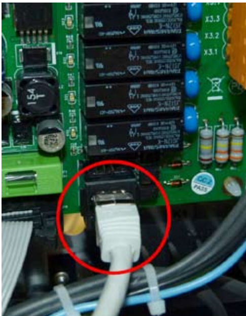
Bild 1 – Bus-Anschluss Stecker RS 485 auf der Steuerelektronik
